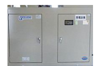
▲非常用電源装置
